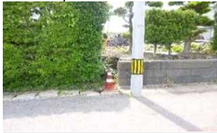
① 溝蓋が老朽化しており、ふたに乗ると危険。
